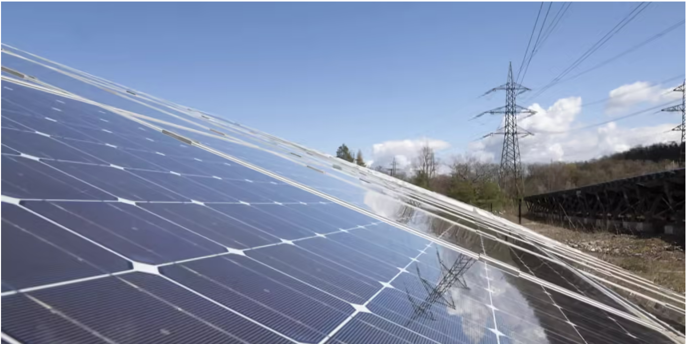
Eine Photovoltaik Anlage in der Schweiz. - Keystone
