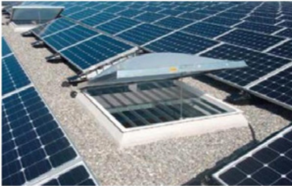
Oblicht mit Gitter gegen Durchbruch gesichert 32
