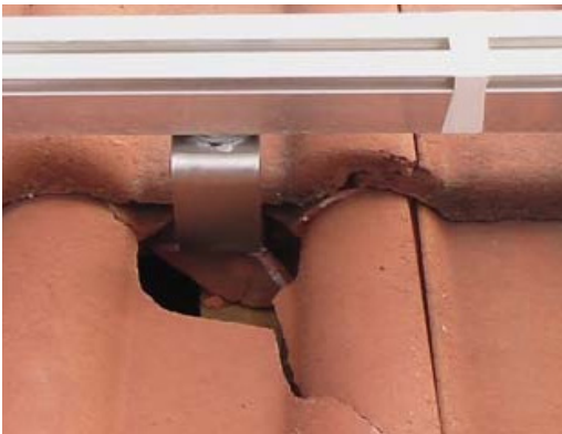
Ziegelbruch durch Montagefehler der Haken
