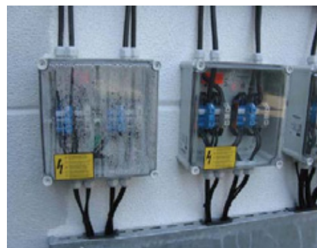
Kondensat im GAK: Abdichtung mangelhaft, muss nachgebessert werden / hohe Kurzschlussgefahr
