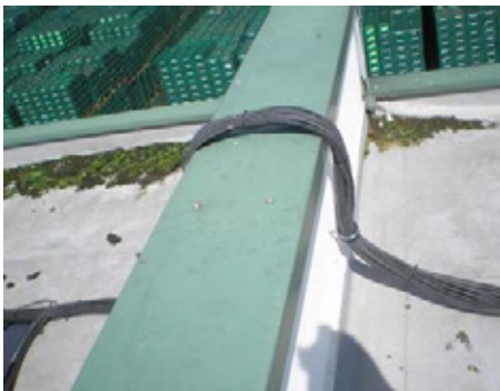
nicht erlaubte Leitungsführung über Brandmauer
