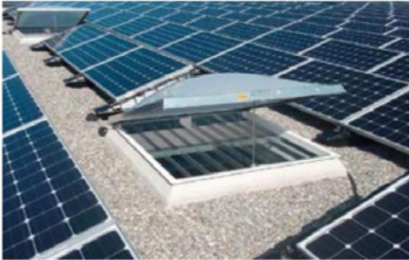
Oblicht mit Gitter gegen Durchbruch gesichert 32
