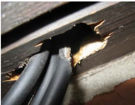
Beschädigungen durch Scheuerstellen
