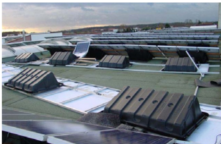
Sturmschaden, Ursache falsche Lastauslegung 63
