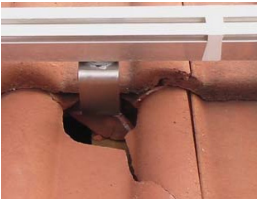
Ziegelbruch durch Montagefehler der Haken
